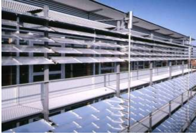
شكل ( 6-19 ) استخدام الكواسر الشمسية على النوافذ للتحكم فى أشعة الشمس المصدر ( www.bomin-solar.de )
